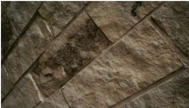
شکل ۲-۵۴- هوازدگی در قطعه سنگ نامرغوب سریعتر از سایر سنگها رخ می دهد(خدابنده، ۱۳۸۹)
