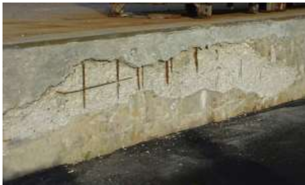
شکل ۲-۴۰- ورقه‌ورقه شدن سطح بتن (گواشیری، ۱۳۹۶)
