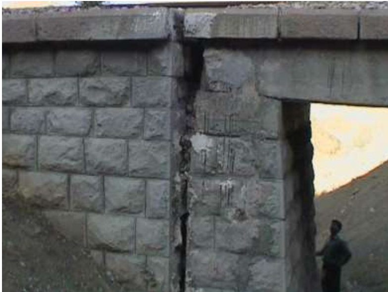
شکل ۲-۵۶- چرخیدن دیوار به سمت داخل دهانه - علامت نشست نامتقارن فونداسیون (خداپنده، ۱۳۸۹)
