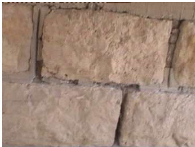
تصویر ۲-۵۱- خراشیده شدن و قلوه کن شدن ملات بنایی (خدابنده، ۱۳۸۹)
