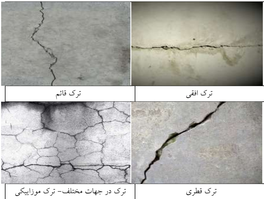
شکل ۲-۴۵-انواع ترک در بتن (گواشیری، ۱۳۹۶)
