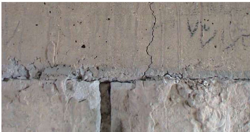
شکل ۲-۵۵- نشست موضعی پی باعث ترک سازه ای در دیوار شده است (خداپنده، ۱۳۸۹).
