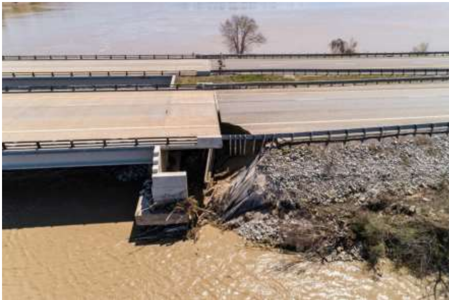
شکل ۲-۳۴- فرسایش خاکریز پشت دیوار کوله به علت زهکشی نامناسب
