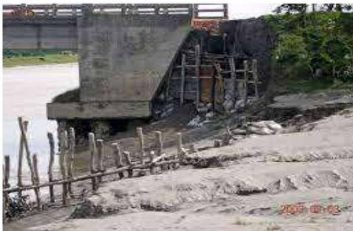
شکل ۲-۳۵- فرسایش خاکریز پشت کوله
