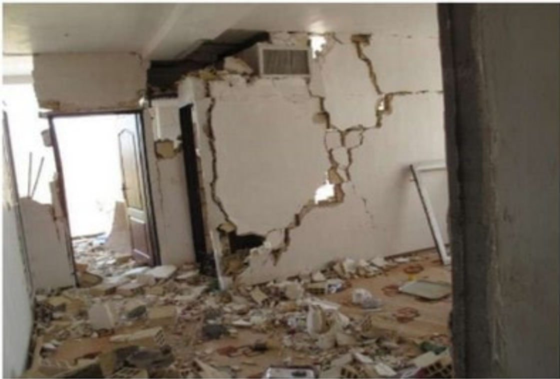
شکل ۱۳- شکست برشی دیوار و در معرض آسیب قرار گرفتن کانال تأسیسات در زلزله کرمانشاه
