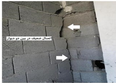
عدم اتصال و مهار مناسب دو دیوار متقاطع در محل تقاطع
