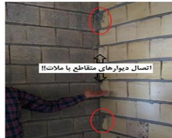
عدم استفاده از وادار برای اجرای دیوارهای متقاطع داخلی و پیرامونی
