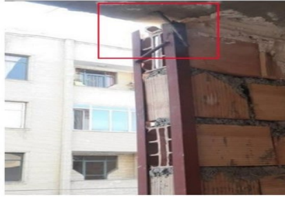
مهار وادارها با میلگرد و خال جوش و ضعف در برابر نیروهای زلزله
