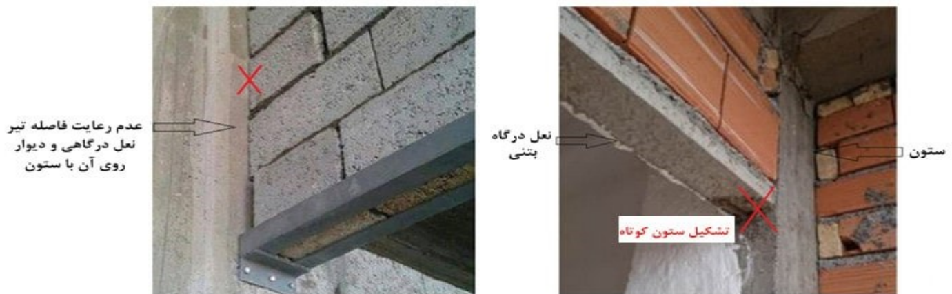
شکل ۱۱- اتصال مستقیم نعل درگاه به ستون و ایجاد پدیده ستون کوتاه
