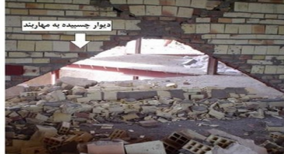
اجرای نادرست دهانه مهاربند، اندرکنش بین دیوار و مهاربند و تخریب دیوار
