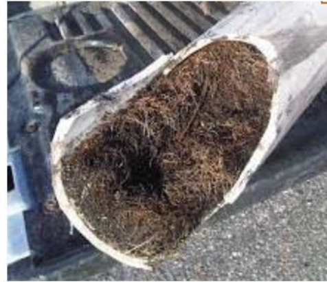
ج - انسداد ناشی از عدم استفاده از فیلتر مناسب در اطراف لوله زهکش
