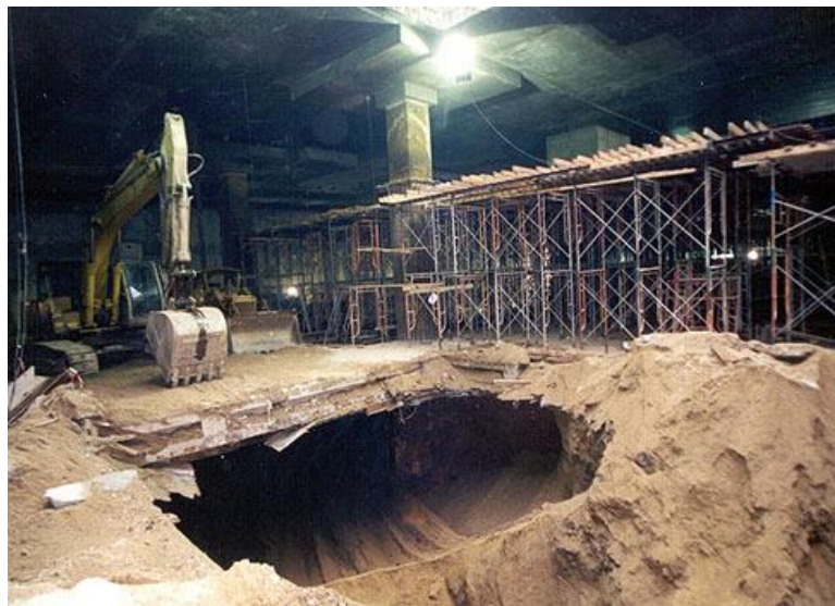
شکل ۶-۱ انجام خاکبرداری زیر دال اجرا شده در حالیکه ستون‌ها و سقف طبقات فوقانی اجرا شده است.
