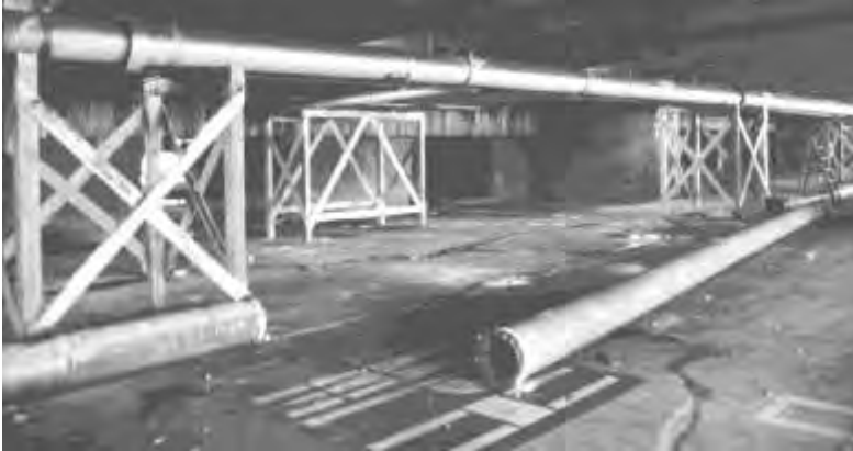
شکل ۶-۱۲ خرابی در سیستم لوله‌کشی ساختمان
