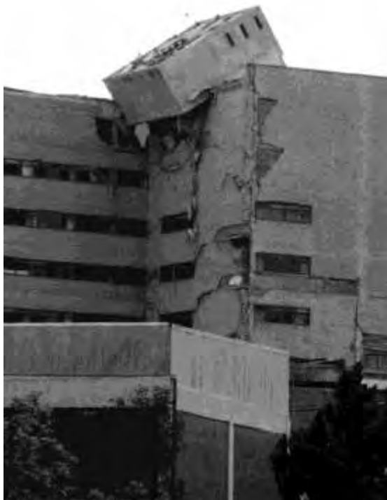
شکل ۱۲-۷ شکست در خرپشته یک بیمارستان در حین زلزله مکزیک (۱۹۸۵)
