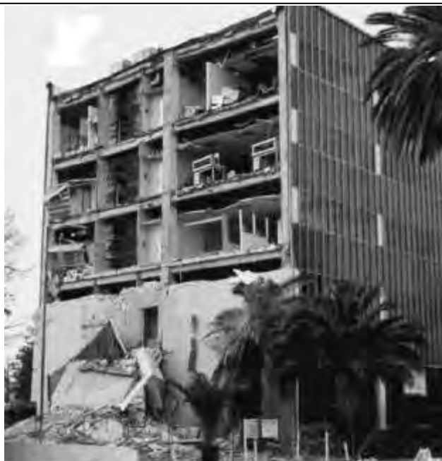
شکل ۸-۱۲ خرابی در نمای یک ساختمان در حین زلزله نورتریج (۱۹۹۴)
