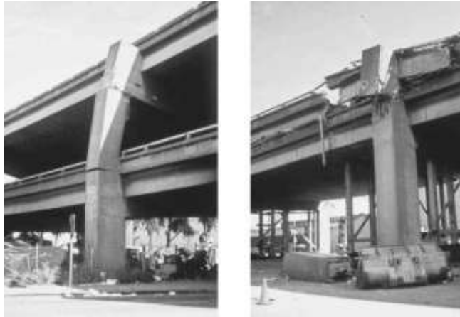
شکل ۱-۲۳ خسارات ایجاد شده در زلزله لومپرتنا
