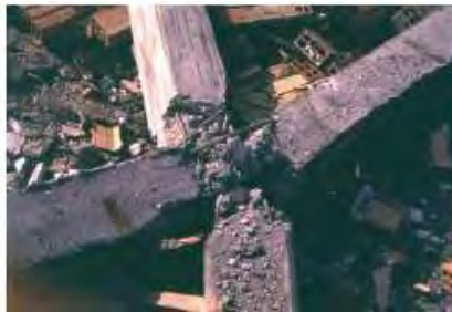
شکل ۱۱-۱ خرابی ساختمان بتنی در رشت که به دلیل ضعف اتصالات در زلزله منجیل
