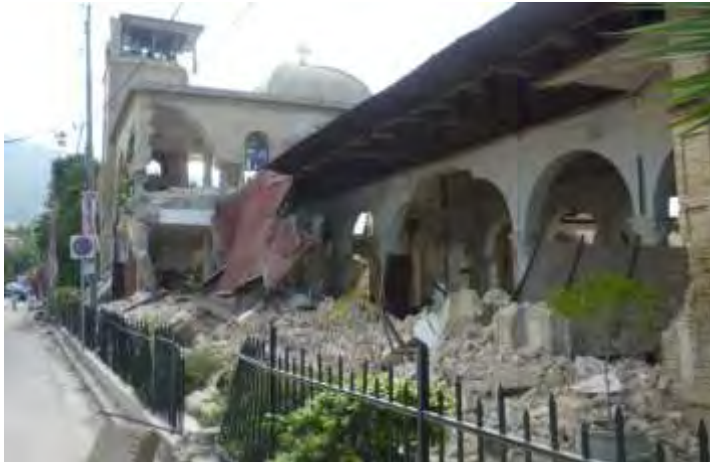
شکل ۱-۲۵ بخشی از خسارات ایجاد شده در زلزله هاییتی
