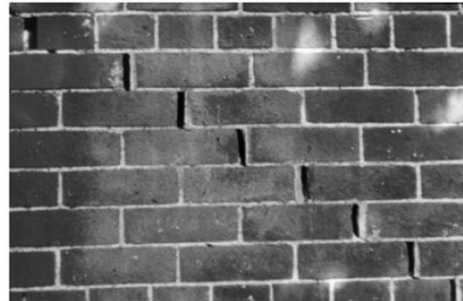
لغزش درز ملات پس از ترک خوردگی قطری
