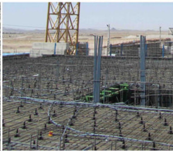
لوله های برق در آرما تور سقف
